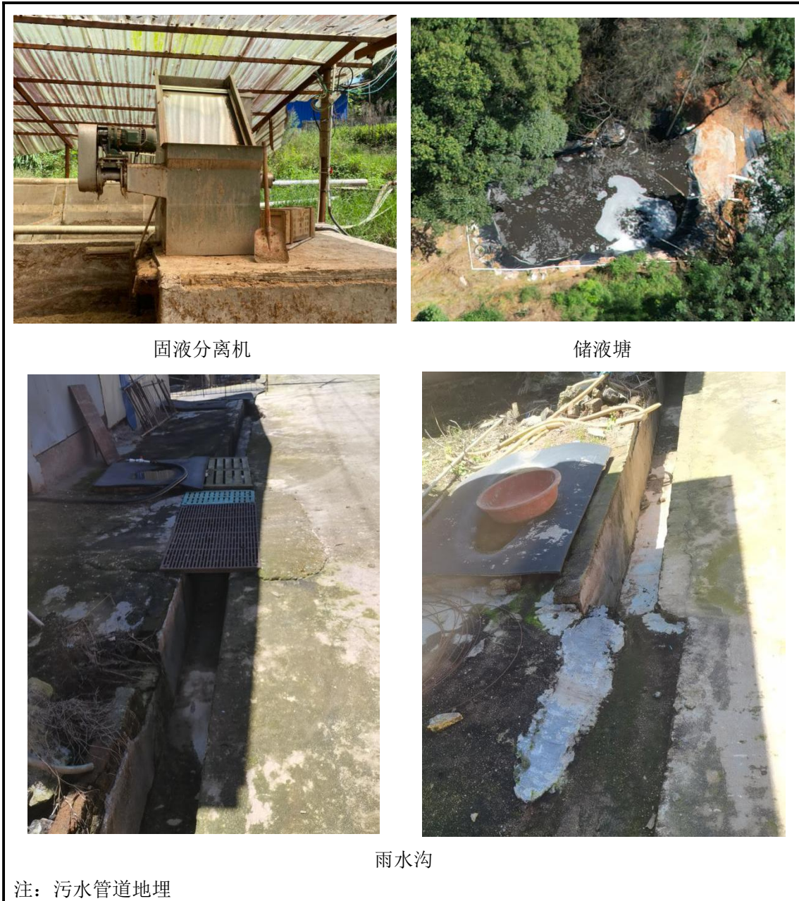
图 3.2-6 污水处理设施照片
