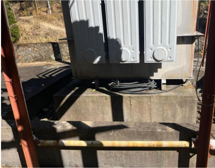
图 5.2-1 变压器事故油池
