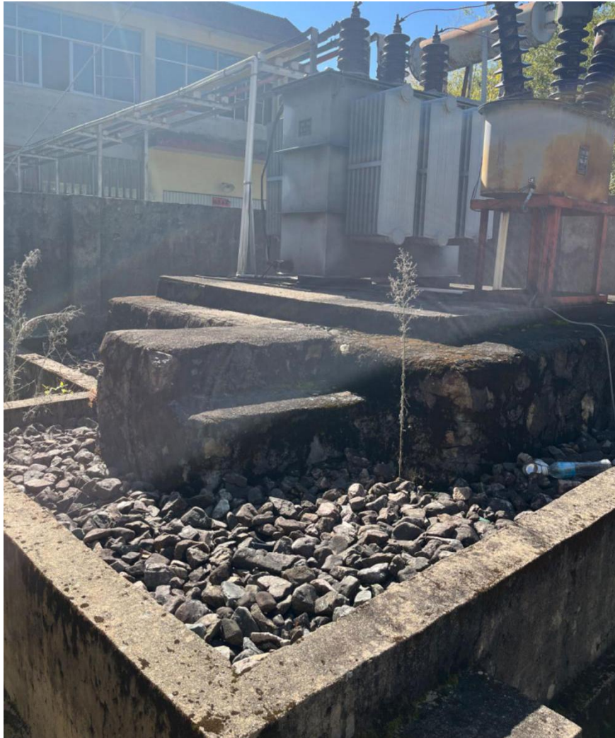
图 5.2-2 变压器事故油池
