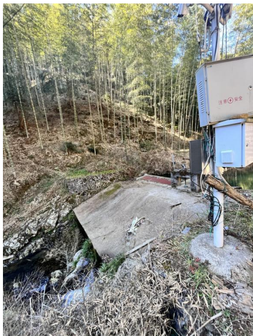
拦水坝及下泄流量监控设施
