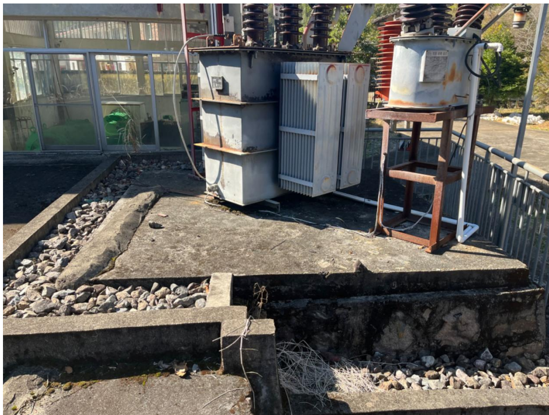
图 5.2-2 变压器事故油池
