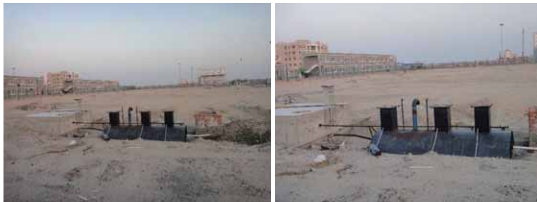
图 5.1-1 生活污水处理装置
