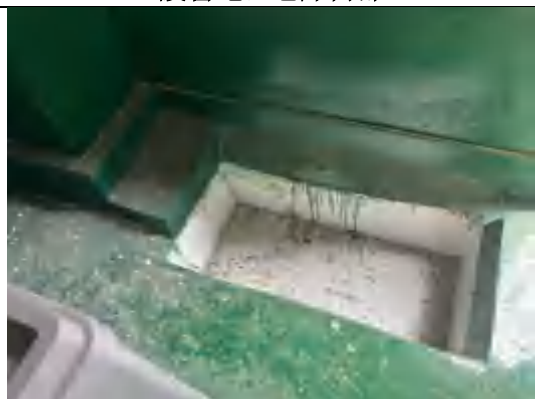
危废间 边沟与收集池
