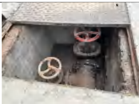
事故应急池转换阀
