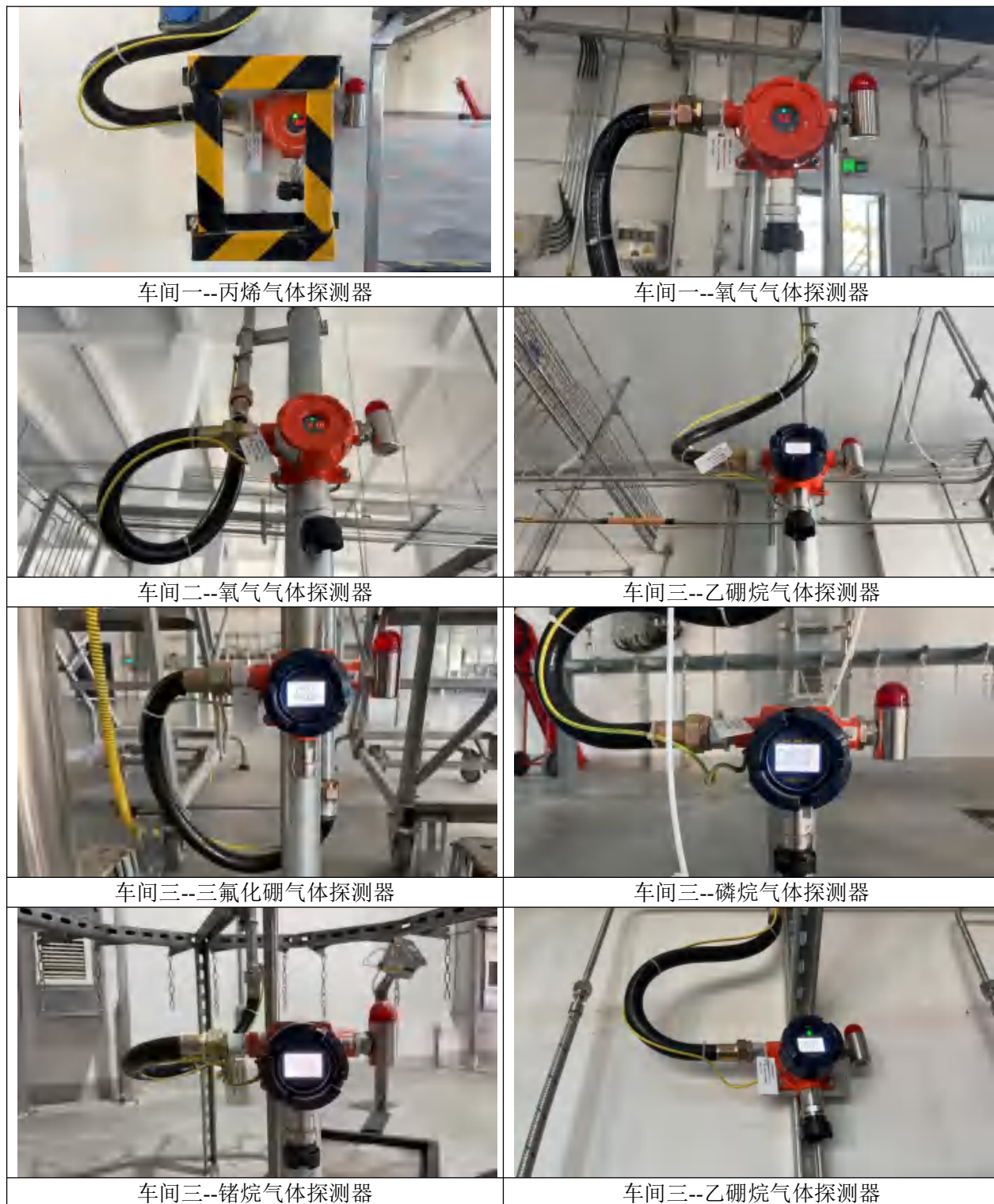
图 4.8-2 GDS 监测系统探测器照片
