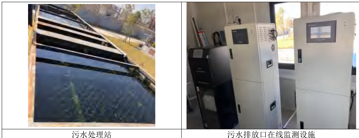
图 4.8-1 废水排放口及监测设施
