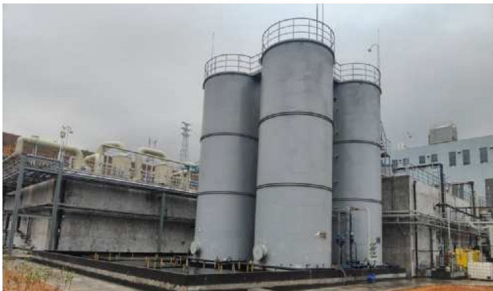
地块三-污水处理站
