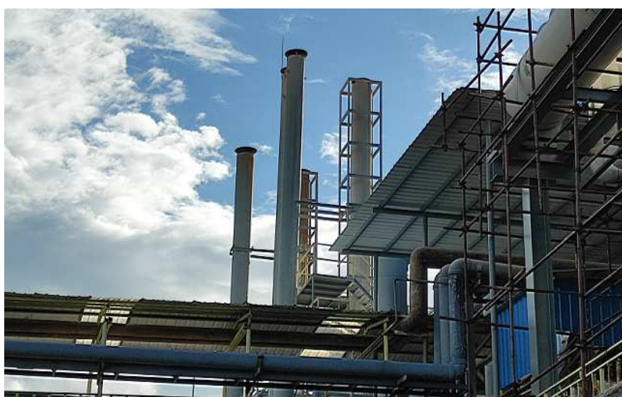
地块一 AHF 燃气热风炉排气筒 (DA006、DA007、DA008、DA009、DA011)
