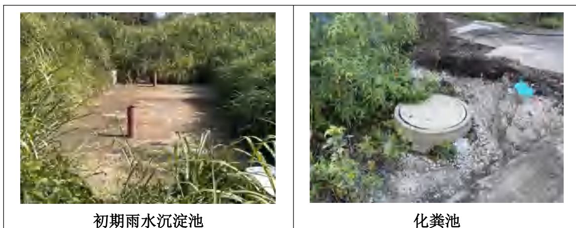
图 4-1 初期雨水收集池和化粪池
