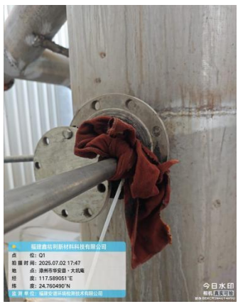
Q1锅炉、焙烧、烧成尾气治理设施出口
