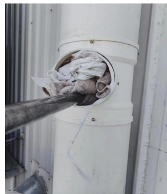
Q8清吹筛分粉尘治理设施出口
