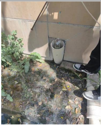
S1化粪池出口
