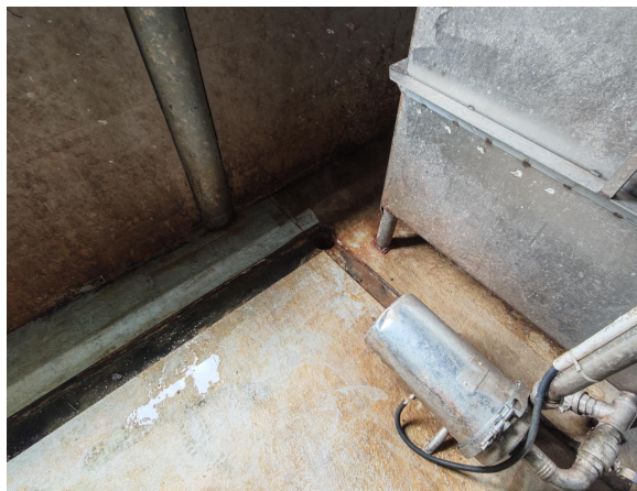
车间污水收集管道
