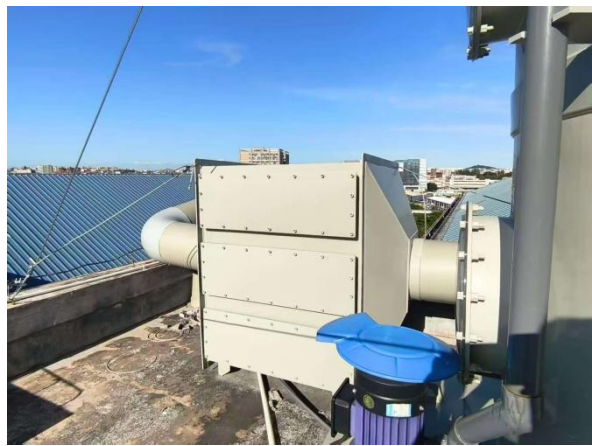
废气处理设施
