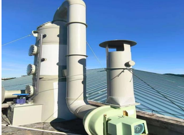
废气处理设施出口
