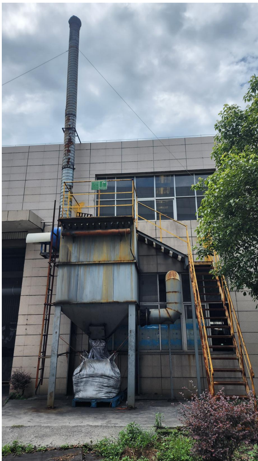
粗加工废气：采用集气管道+布袋除尘器+15m 高排气筒（DA001）达标排放
