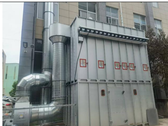
布袋除尘设施
