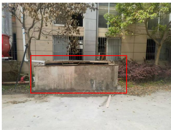
图 3.1 废水处理设施——混凝沉淀池
