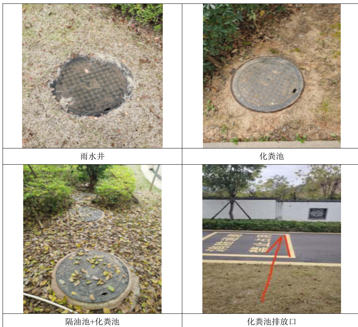
图 4.2-1 废水治理设施图
