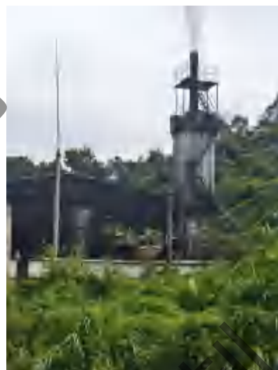
锅炉废气排放口
