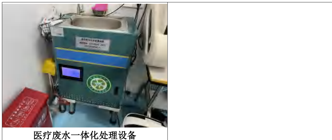
图 4.1-3 项目废水环保设施照片
