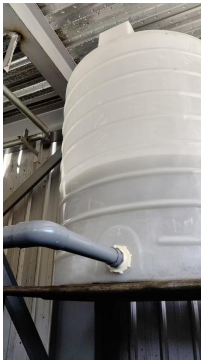
柔软剂稀释用水集水罐
