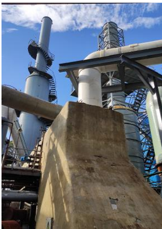
地块一硫酸线、AHF 线排气筒 (DA002、DA003)
