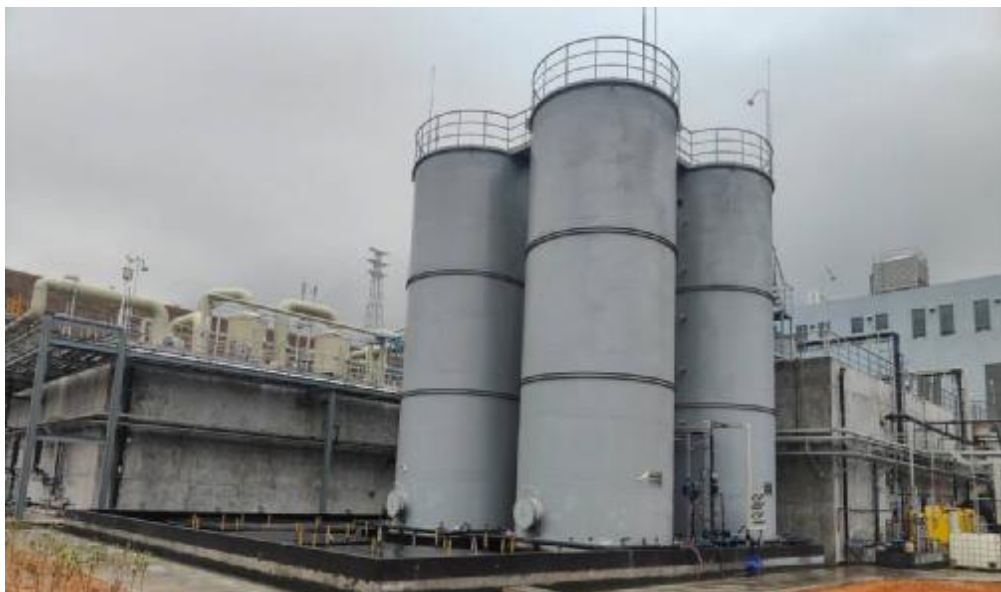
地块三-污水处理站
