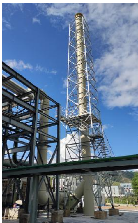
地块三无机废气排气筒 (DA018)
