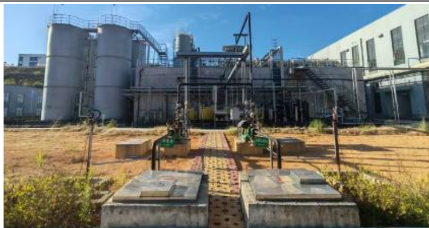
地块三埋地初期雨水池及事故应急池、污水处理站
