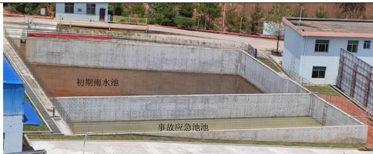
地块一初期雨水池及事故应急池
