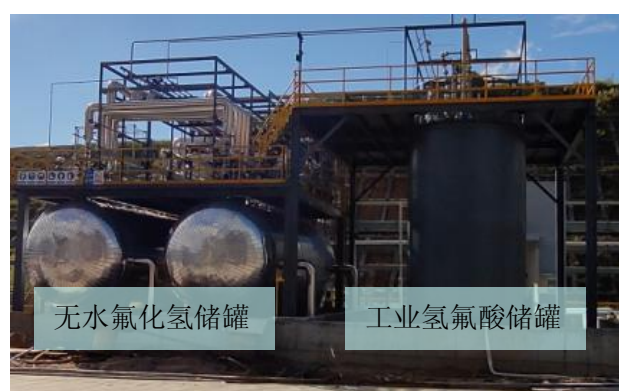
地块三氟化氢罐组
