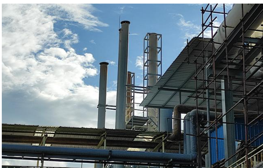
地块一 AHF 燃气热风炉排气筒 (DA006、DA007、DA008、DA009、DA011)
