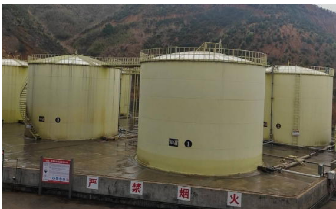
地块一硫酸储罐
