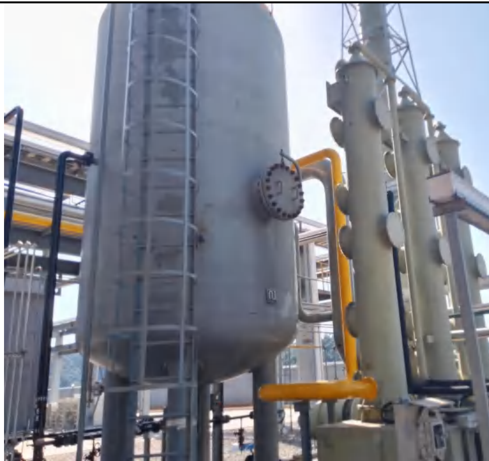
有机胺中间体工艺废气治理设施（一级水洗+二级酸洗）
