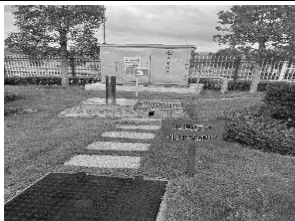
雨水总排放口及其闸阀、新增天然 气管道主供气闸阀控制室
