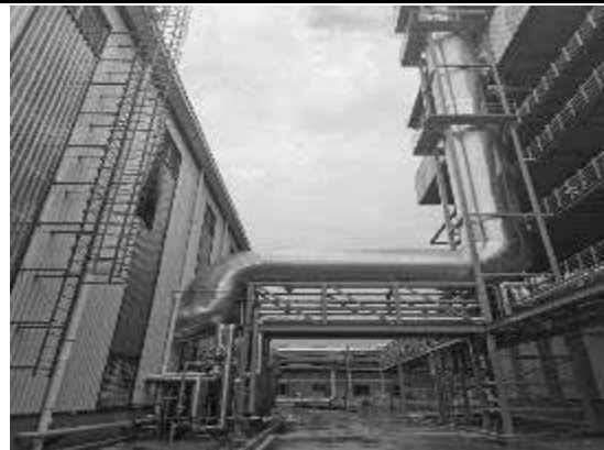
炭活化热解气空气换热后热空气外供 管道（外供元力硅材料）
