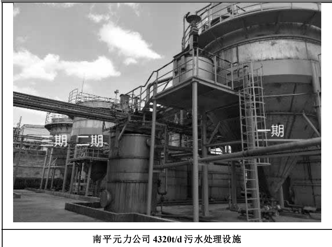
图 4.1-2 项目污水处理设施现场情况
