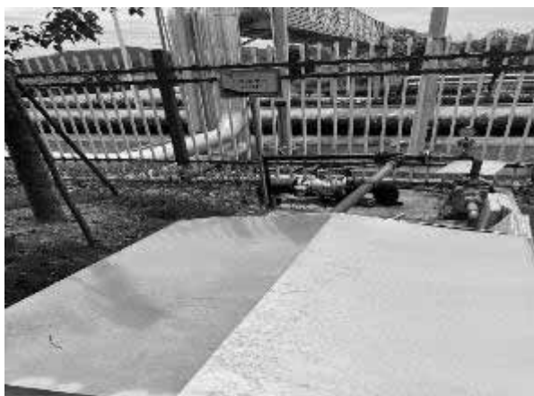
900m³初期雨水池
