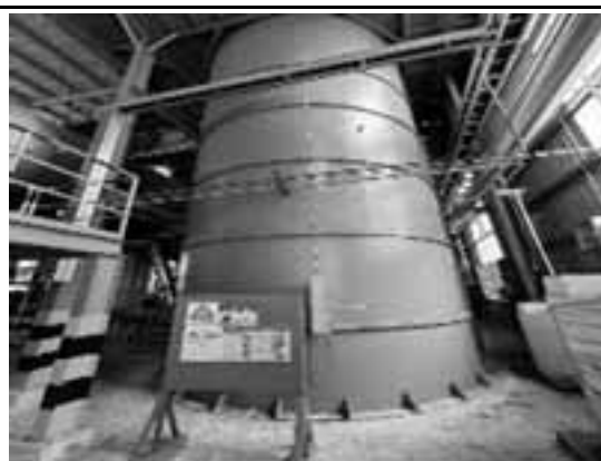
旋喷炉（燃烧室）
