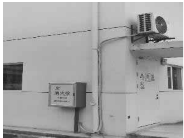
消防器材（空气站）
