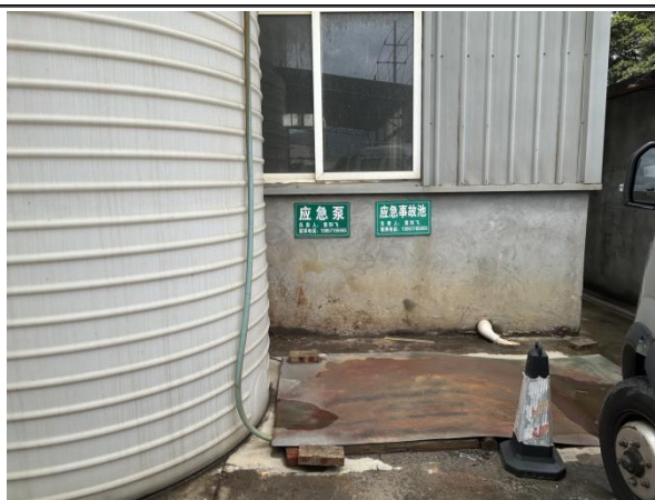
事故应急泵及应急池
