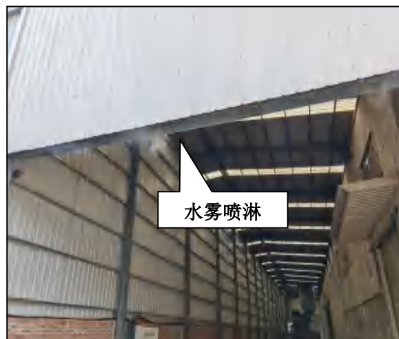
图 4-1-8 出入口水雾喷淋
