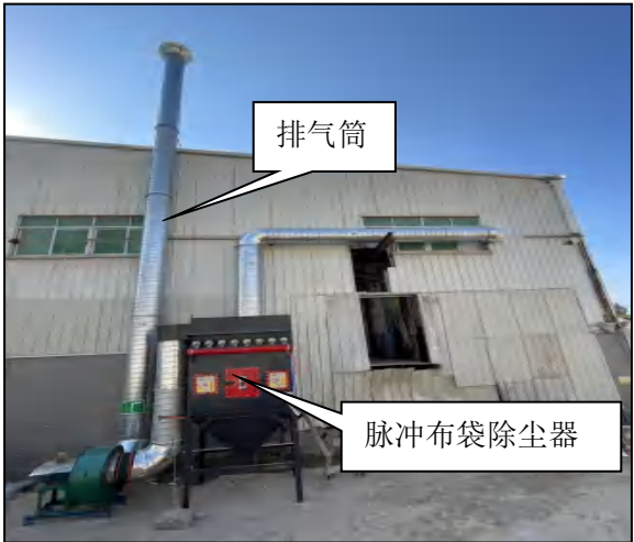
图 4-1-2 脉冲布袋除尘器+排气筒
