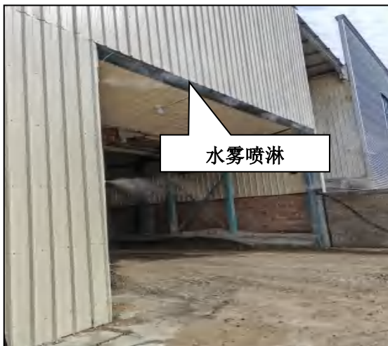
图 4-1-7 出入口水雾喷淋
