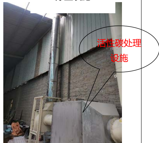
DA002 热压废气排气筒
