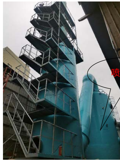
DA004 热风炉排气筒
