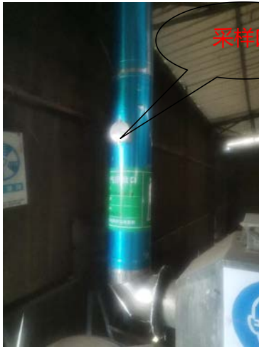
DA003 采样口和废气标志
