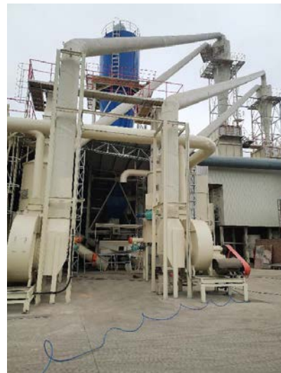
热风炉二级旋风除尘装置
