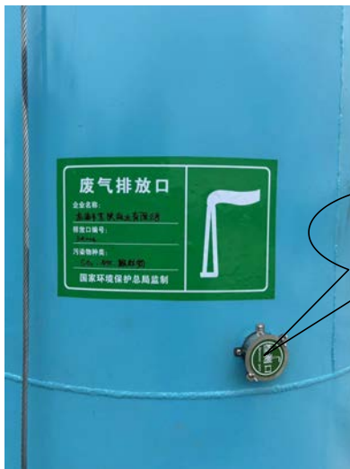
DA004 采样口和废气标志
