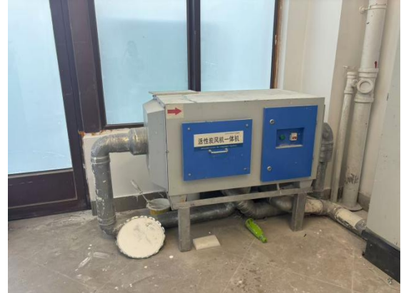
污水站活性炭吸附箱体
