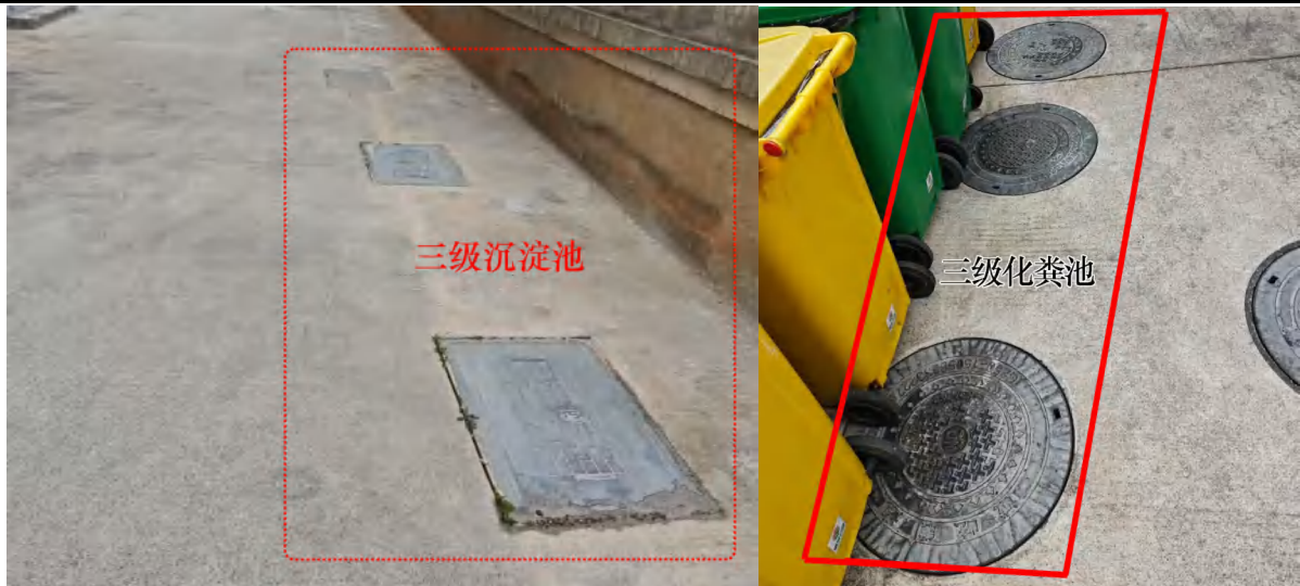
图 3.1-1 本项目污水处理设施现场图
