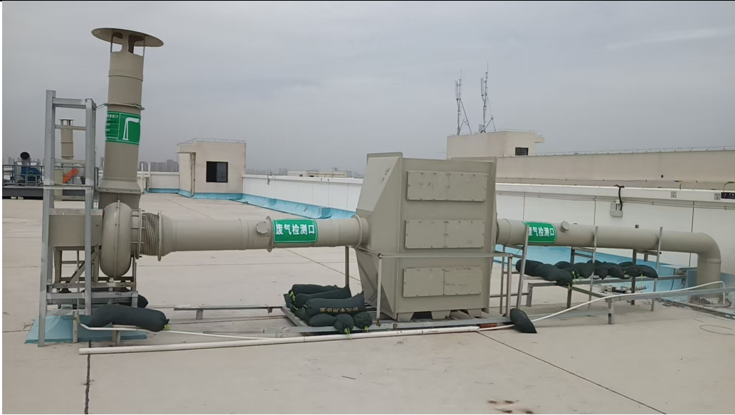
图 3-1 废气治理措施现场照片
