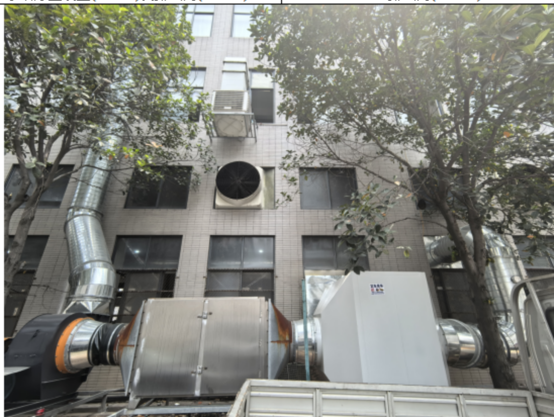
废气处理设施(TA003)及废气收集管道
