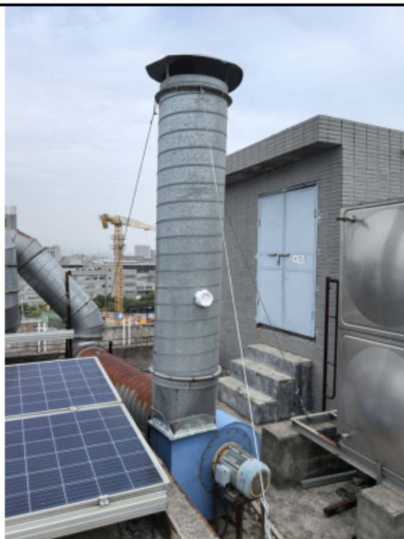
水浴除尘装置(TA001)及排气筒(DA001)
