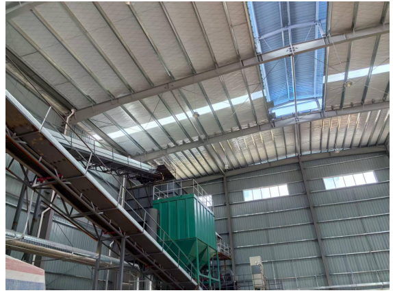
破碎粉尘 1-布袋除尘器
