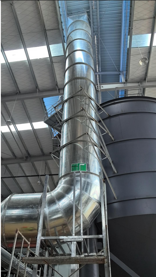
矿石彩砂废气排放口-18m 排气筒 FQ-21359
