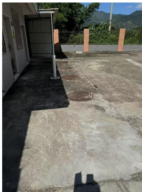
地埋式污水处理站
