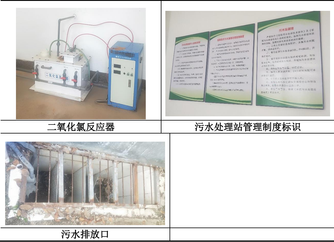
图 5-2 废水处理设施情况
