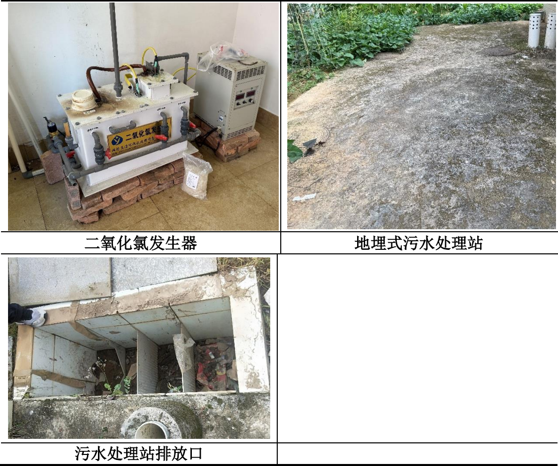
图 5-2 废水处理设施情况
