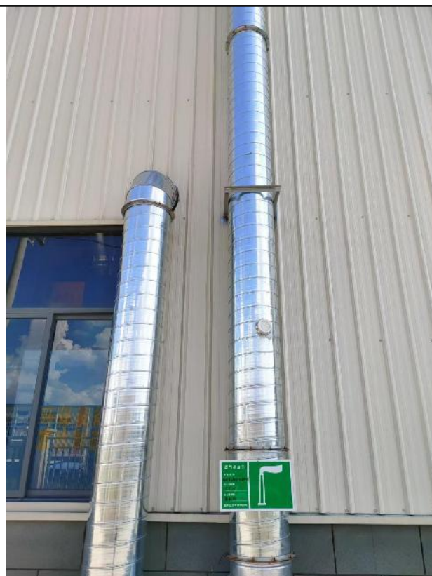
抛丸废气排气筒 DA001
