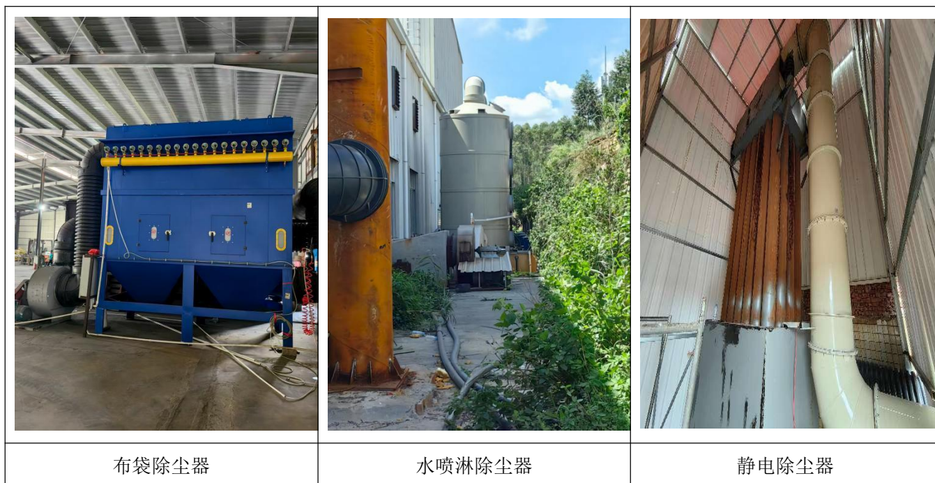
图 4.1-3 项目废气治理设施图
