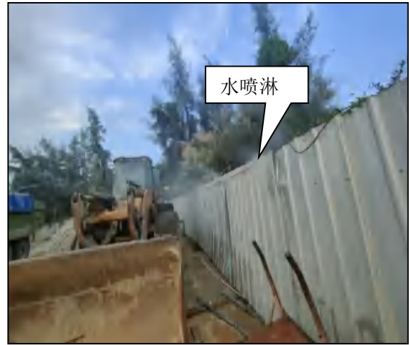
图 4-1-10 厂界围挡水喷淋
