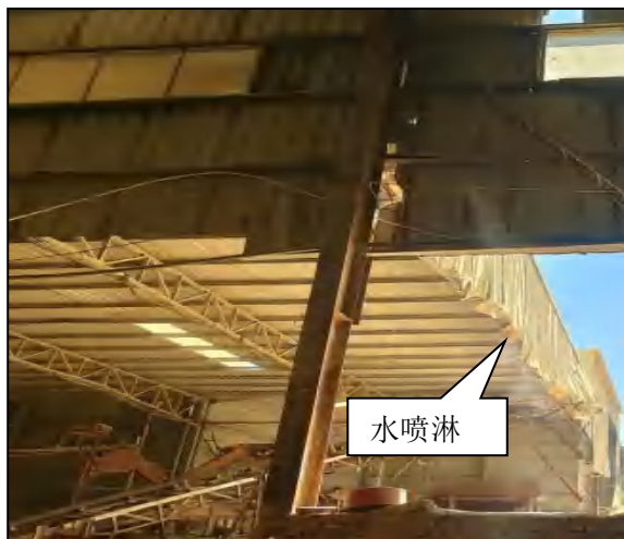
图 4-1-7 车间出入口水喷淋
