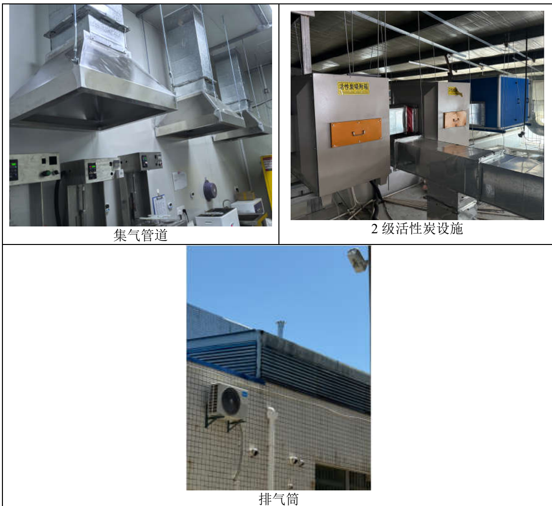
图 4.1-2 项目废气治理设施
