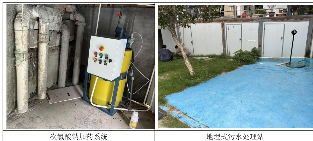
图 3.2-2 废水处理设施现状图
