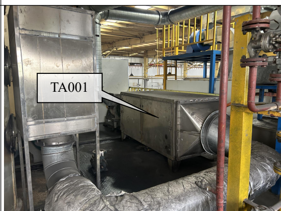
1#厂房 1 号注塑车间三级活性炭吸附 (TA001)
