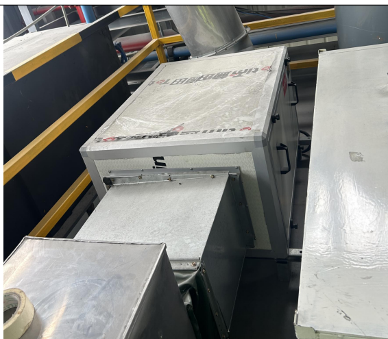
2#厂房 袋式除尘器+活性炭 TA007 (焊接+有机废气)
