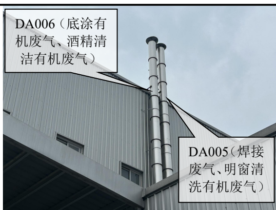
2#厂房 排气筒 DA006、DA005
