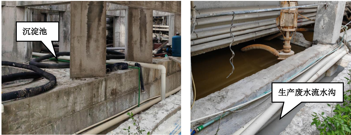
图 4-3 生产废水处理设施
