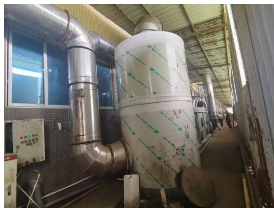
生物除臭喷淋+15m排气筒
