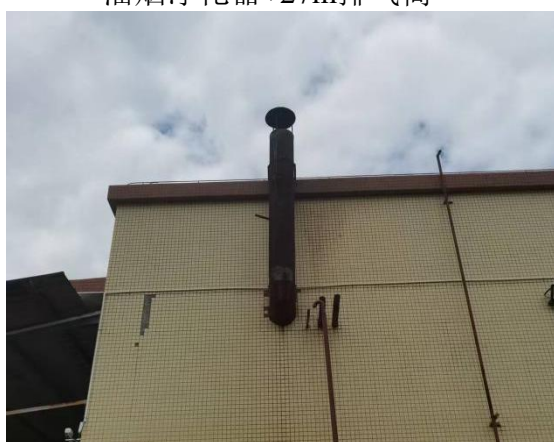
锅炉烟气 15m 排气筒
