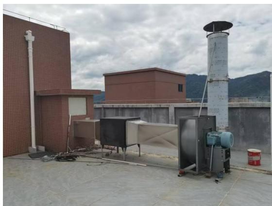
油烟净化器+27m排气筒
