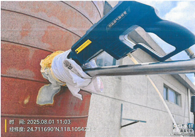
DA001 有机废气排放口
