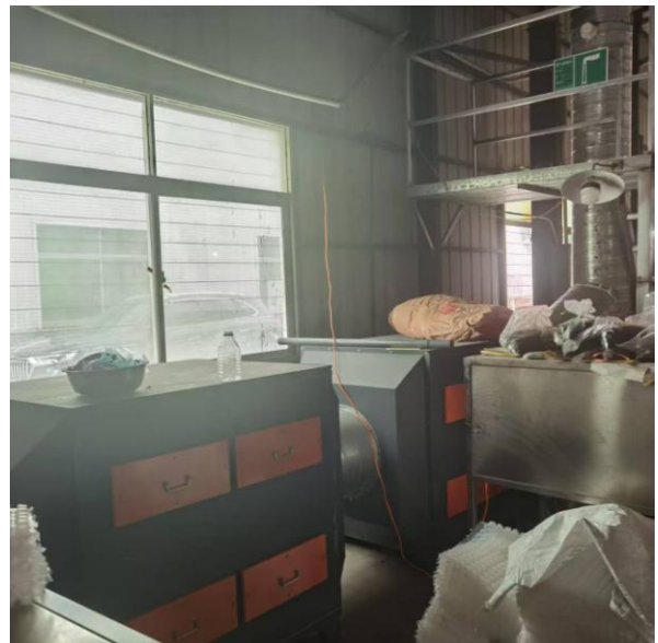
注塑区两级活性炭吸附设施
