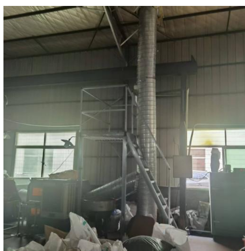
排气筒及监测平台
