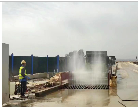
进出车辆冲洗台
