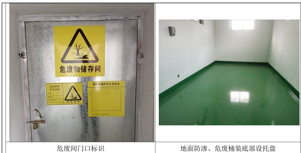
图3-2 项目危废车间治理设施照片
