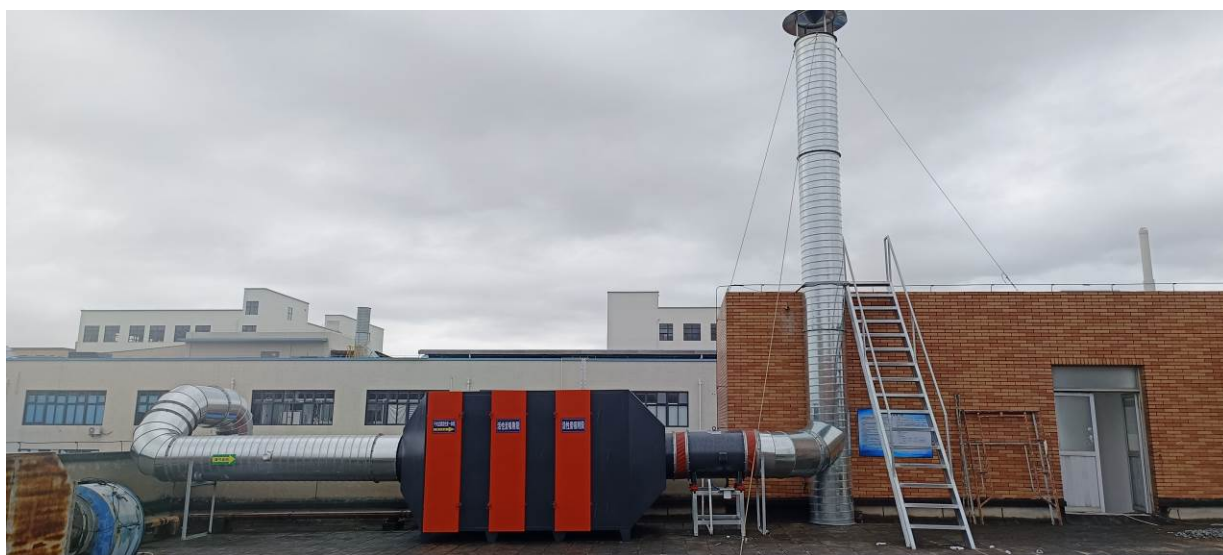
图 3-1 项目废气治理设施照片
