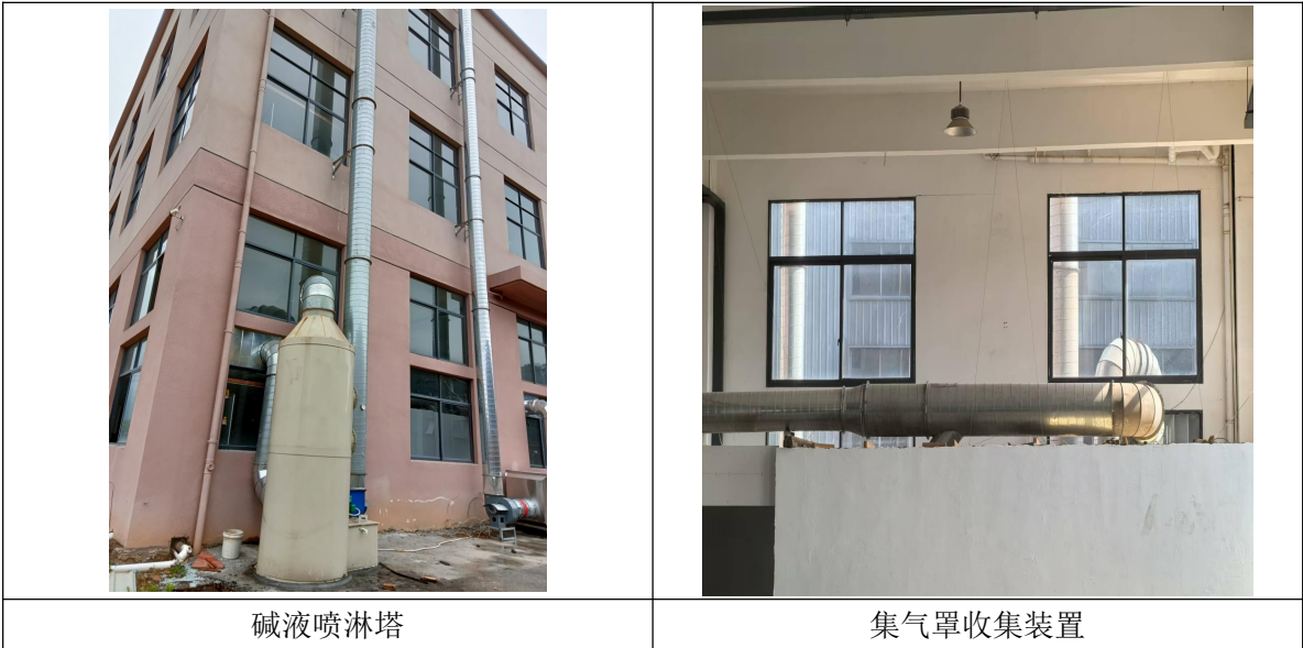
图 3-1 废气处理设施现状图
