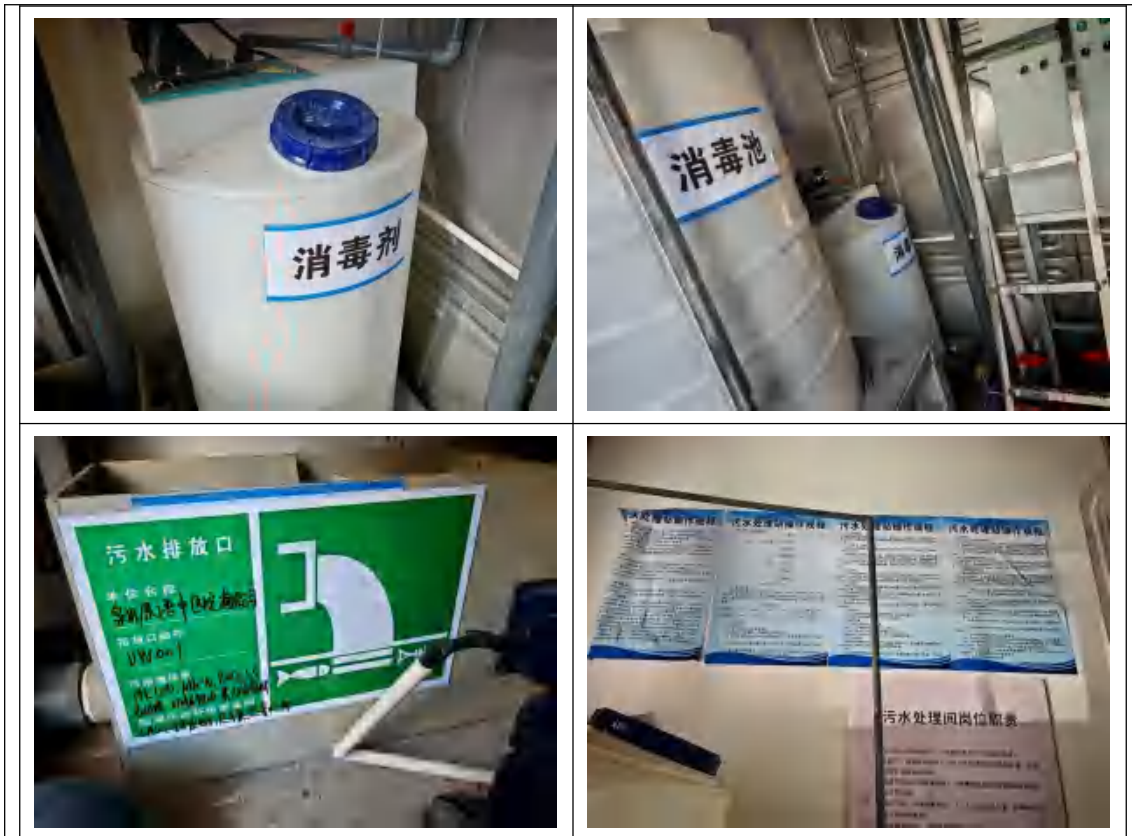
图 3-4 本项目废水处理设施
