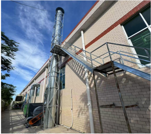
有机废气排气筒
