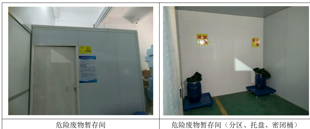
图4-3 项目污染物处理设施
