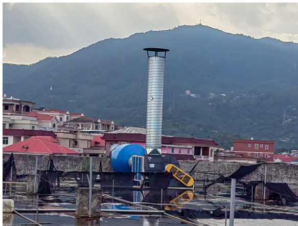
除雾装置+活性炭吸附装置+24m高排气筒 （喷漆废气）
