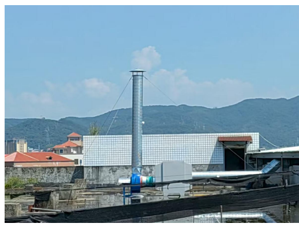
活性炭吸附装置+23m高排气筒（注塑废气）
