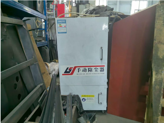
工业袋式除尘器（打磨废气）
