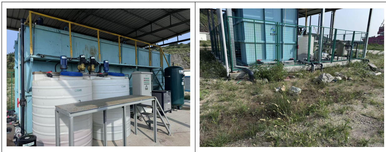
图 4-1 船坞废水处理设施
