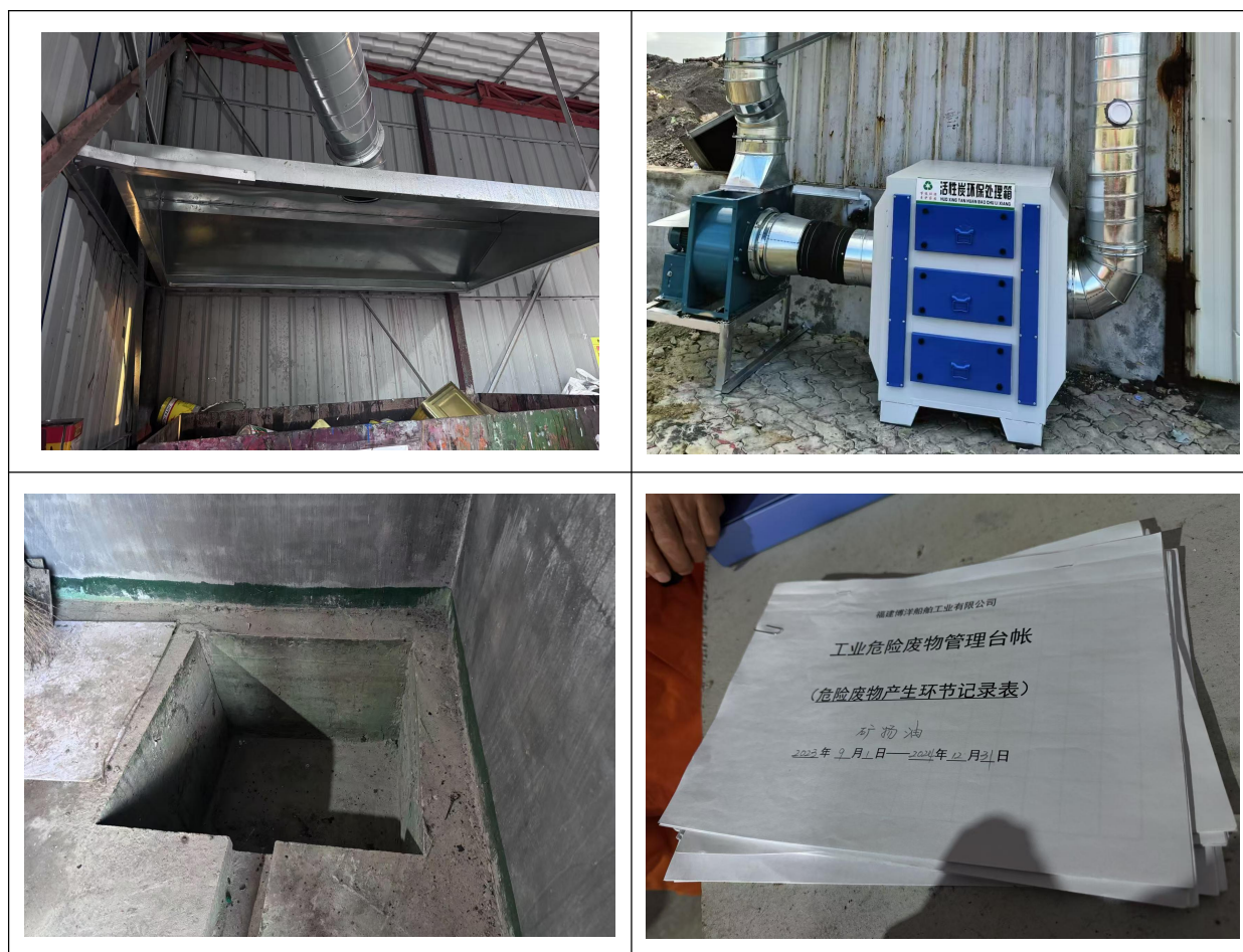
图 4-3 危险废物暂存间
